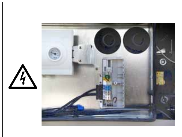
Рис.: Клеммная коробка: Опасность поражения электрическим током
