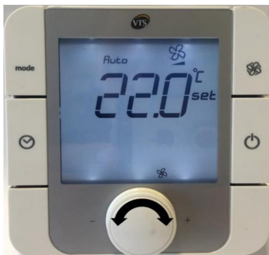
Рис. 33. HMI Basic. Установка температуры.
