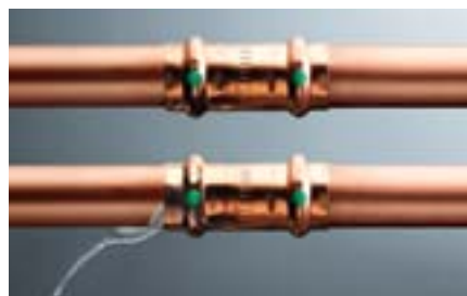
Вверху: опрессовано = герметично. Внизу: видно отсутствие опрессовки.
