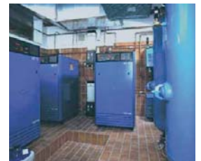
Системы сжатого воздуха: мониторинг осушителя для предотвращения повреждений вызванных влагой
