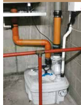
SANICUBIC® 2 XL расположена на техническом этаже
