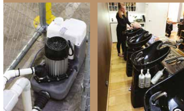
SANICOM® 1 установлена в салоне красоты
