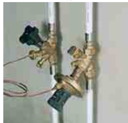
Подключение регулирующей арматуры на стояках
