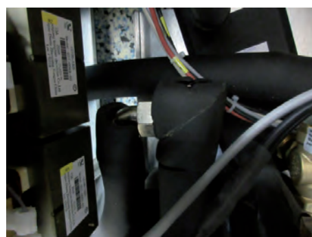
Підключення зворотки теплового насоса
