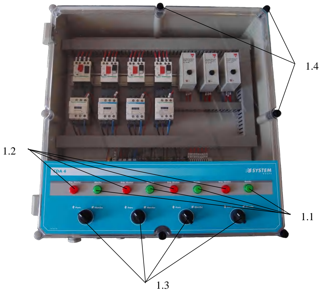
Рисунок 1 – Шкаф управления CDA. Общий вид
