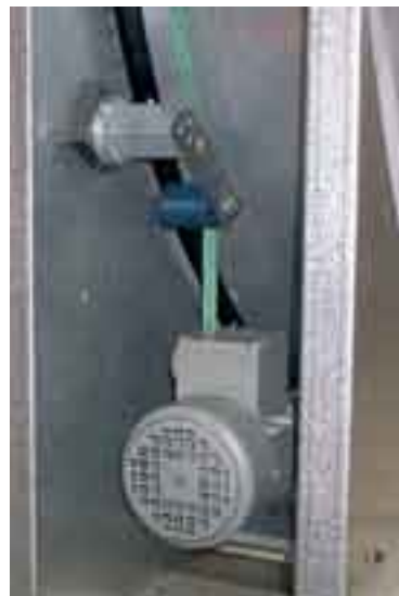
Электродвигатель роторного рекуператора
