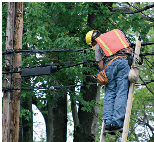
Рис. 1.5. Ответвление от линии воздушных передач
