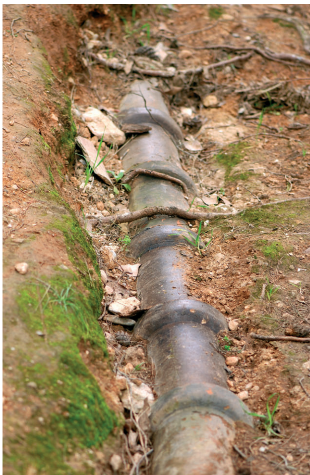
Рис. 4.24. Неправильное расположение трубы выше уровня грунта
