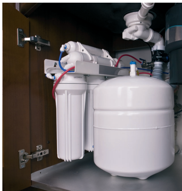
Рис. 3.35. Система фильтрации воды, установленная в доме
