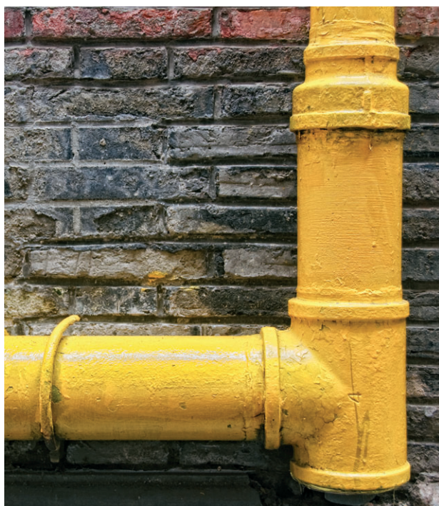
Рис. 4.2. Металлические водопроводные трубы
