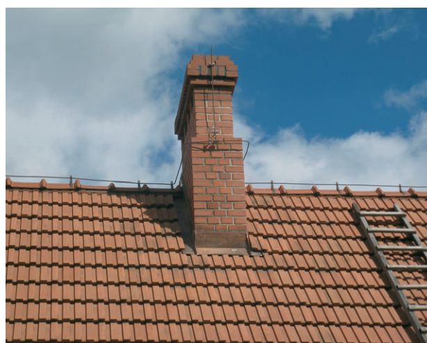
Рис. 1.52. Молниеприемник на крыше дома
