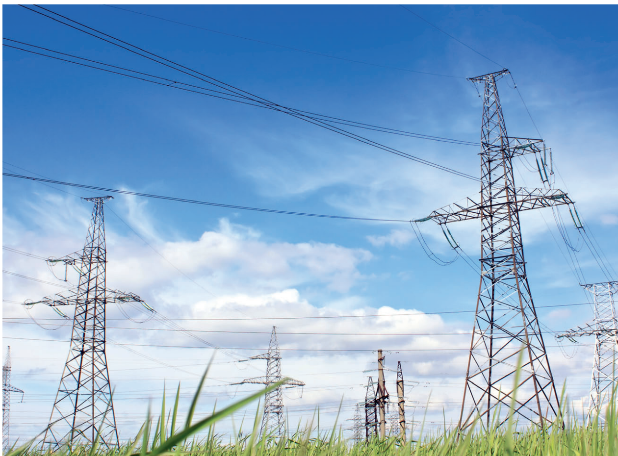
Рис. 1.1. Линии воздушных передач
