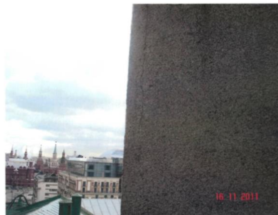
Фото 16 Вертикальная трещина в штукатурном слое верхней зоны башни.
