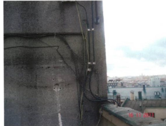
Фото 15. Вертикальная трещина в штукатурном слое верхней зоны башни.
