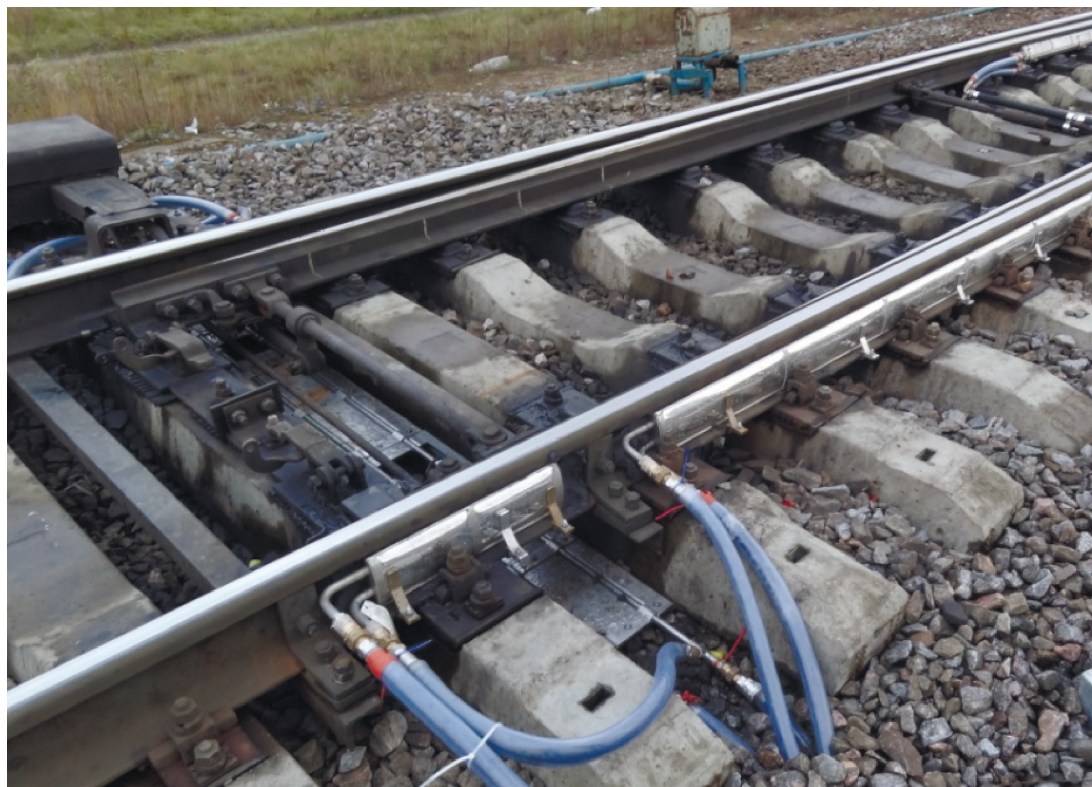
Рис. 27. Система геотермического обогрева стрелочного перевода
