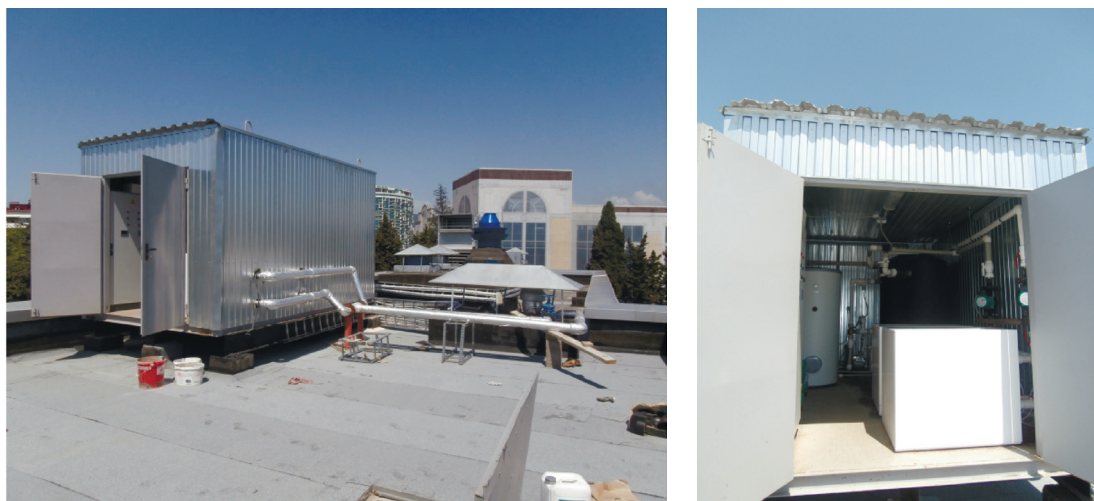
Рис. 24. Фото ИТП торгового центра на сочинской привокзальной площади
