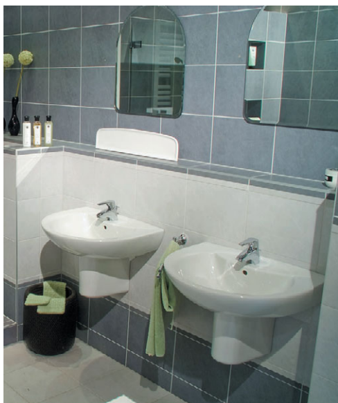
Рис. 10.68. Раковины на полупьедесталах в интерьере ванной комнаты
