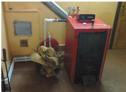
Рис. 12.35. Котельная на твердом топливе
