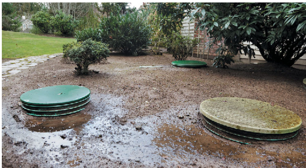
Рис. 8.23. Благоустроенная автономная канализационная система в загородном доме
