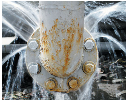
Рис. 2.6. Водопроводные работы без соблюдения технологии ведут к экономическим потерям
