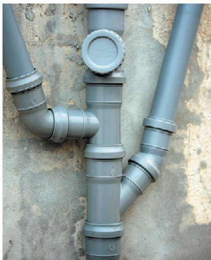
Рис. 8.1. Канализационные трубы в современном доме
