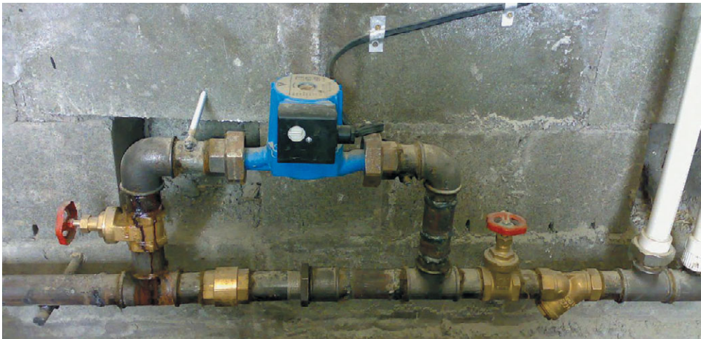
Рис. 2.9. Байпас, установленный в системе отопления
