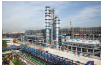
Газпромнефть-МНПЗ, г. Москва
