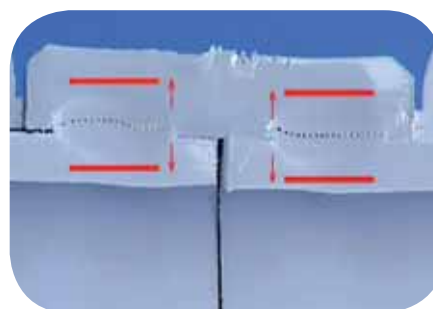
Место сварки имеет толщину материала превышающую толщину стенки трубы
