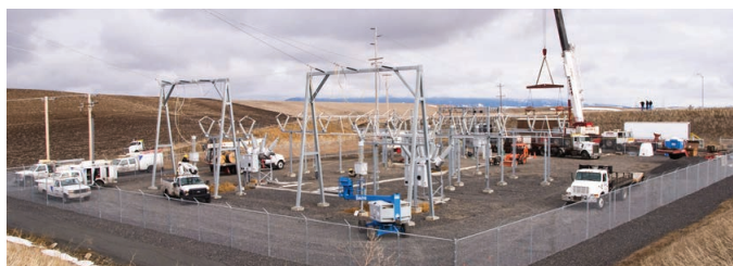
УСЛУГИ ПО ПЛАНИРОВАНИЮ ПОДСТАНЦИИ
