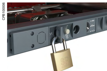
Блокировка навесным замком в положении «выкачено»
