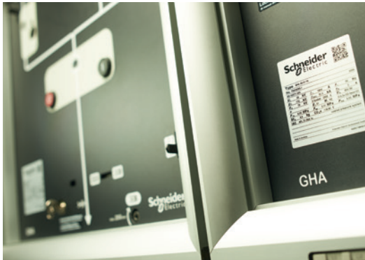
Современная панель управления
