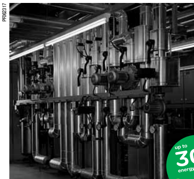
Управление насосной станцией
