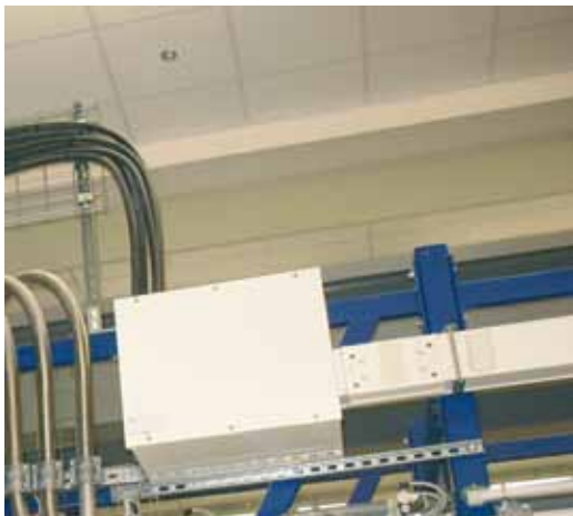
Шинопровод Canalis KS и спринклер
