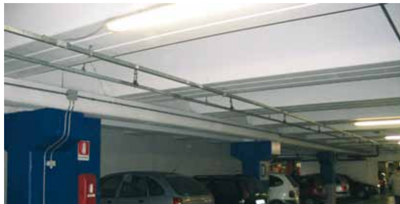
Шинопровод Canalis KVA со светильниками и спринклерами
