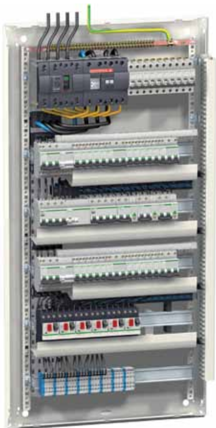
NG160 в модульном шкафу
