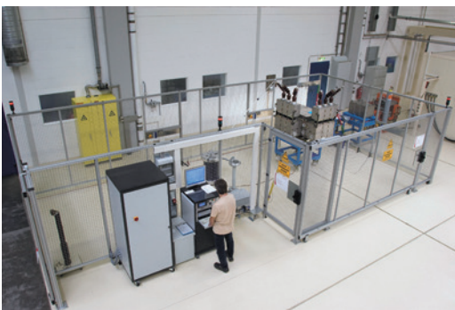
Испытательный стенд для проведения испытаний по проверке электрической прочности изоляции главных и вспомогательных цепей
