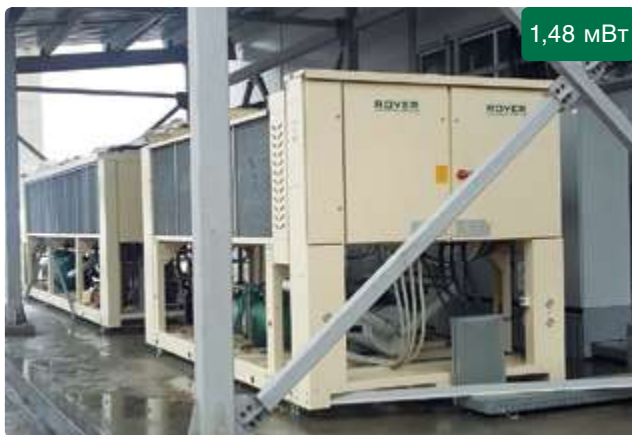
ЗАВОД «РОЛЛ АГРО», ДЗЕРЖИНСК чиллеры воздушного охлаждения с винтовым компрессором
