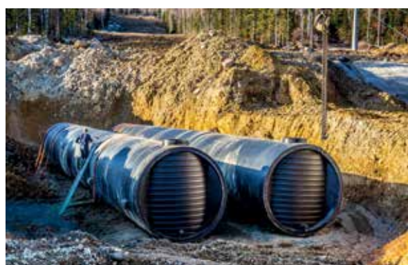
Накопительные резервуары технической воды. Таштагольский район, Кемеровская область, реализация комплексной программы «Развитие спортивно-туристического комплекса «Шерегеш» на 2020–2025 годы».
