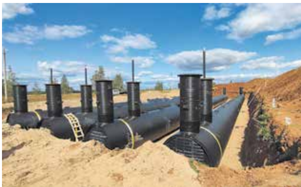
Аккумулирующие резервуары, Село Новая Малыкла Ульяновской области, реконструкция системы водоснабжения.
