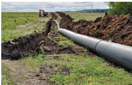
Газопровод среднего давления к объекту «ООО Тепличный комплекс «Тульский», 2019 г.
