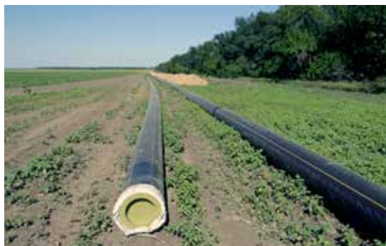
Газификация* завода по производству кукурузного глютена «НьюБио», Волгоградская обл., 2018 г.
