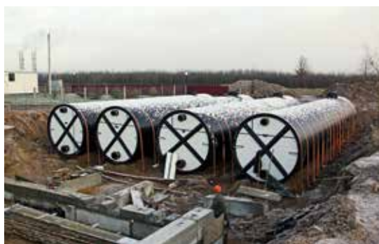
Реконструкция здания утильного цеха и цеха убоя птицы ЗАО «ЮНИМИТ» Беларусь, пос. Октябрьский, 2018 г.
