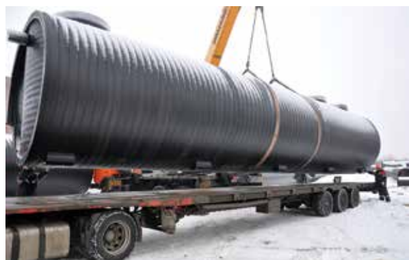
Локальные очистные сооружения поверхно- стного стока, г. Москва, на территории, огра- ниченной пр. Серебрякова, набережной реки Яузы, 1-м Ботаническим пр., Лазоревым пр. и ул. Снежная.
