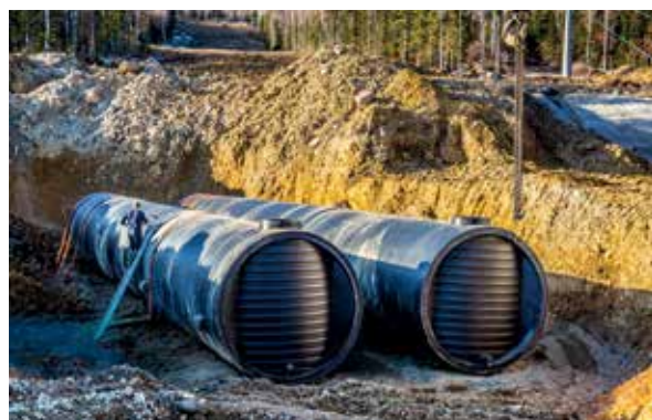
Накопительные резервуары технической воды. Таштагольский район, Кемеровская область, реализация комплексной программы «Развитие спортивно-туристического комплекса «Шерегеш» на 2020–2025 годы».
