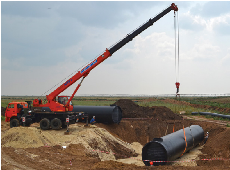
Накопительные резервуары. Хутор Песковатка, Волгоградская область, строительство оросительной системы.
