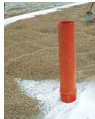
Наземная часть инспекционной трубы диаметром 200мм
