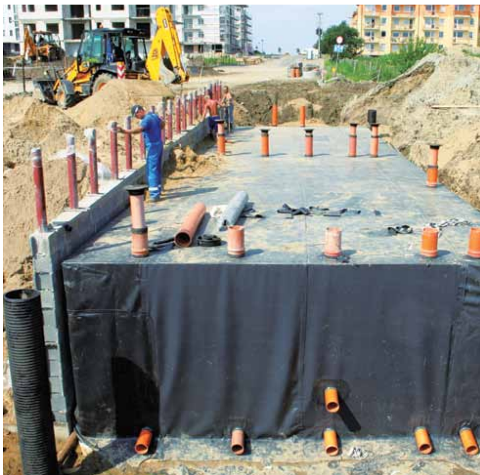
Буферный резервуар в дренажной системе
