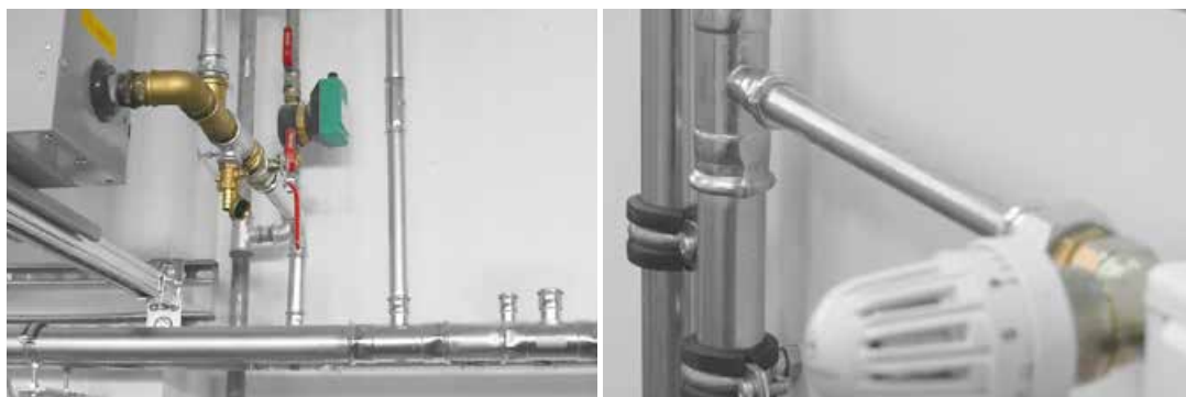
Примеры монтажа оборудования KAN-therm Steel
