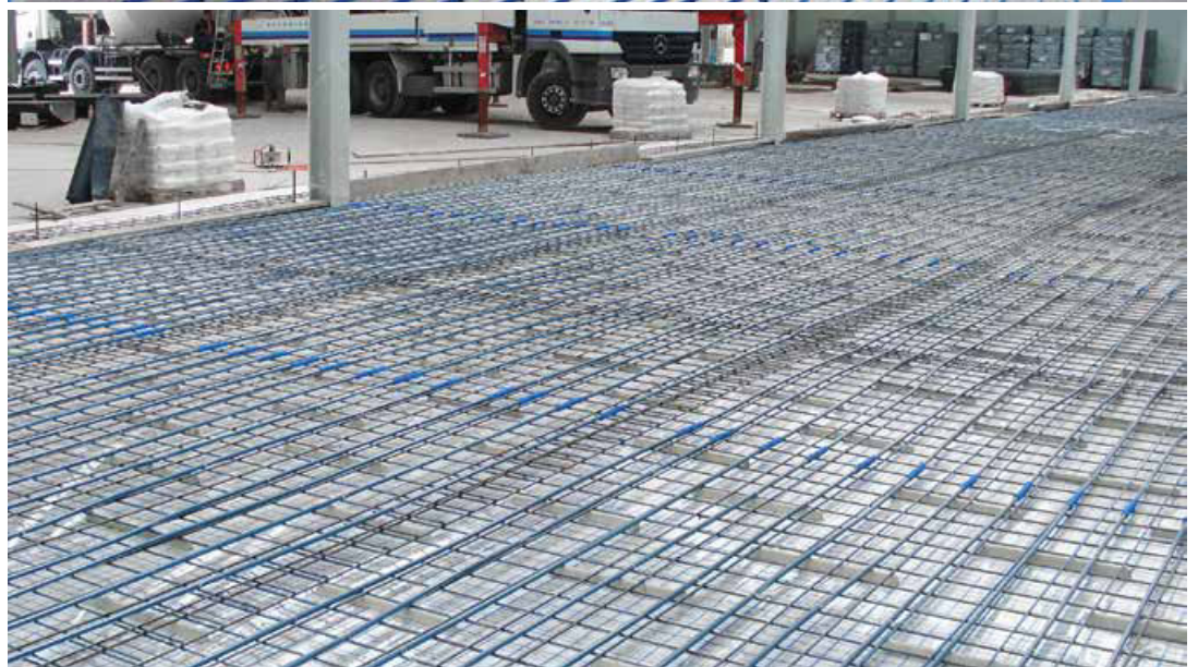
Рис. 4. Система напольного отопления в складском помещении при использовании труб blueFLOOR PERT и системы крепления труб KAN-herm NET.
