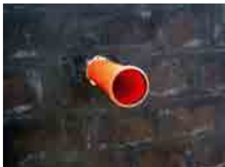
1. Труба проведена через стену с битумным покрытием.
