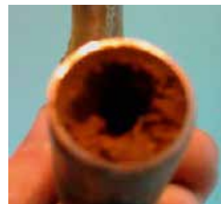
Окисные отложения в трубах
