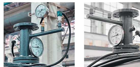
Пример установки приборов КИПиА на проставках
