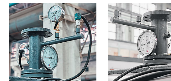
Пример установки приборов КИПиА на проставках
