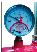
Термоманометр на выходе котла
