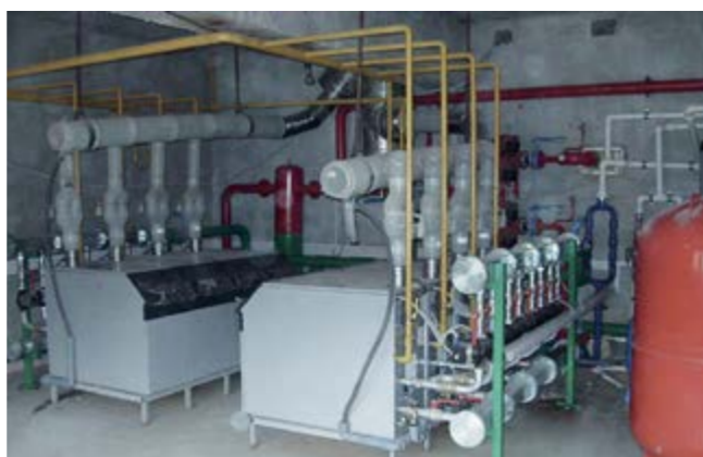
Спорткомплекс «Гладиатор», г. Нальчик Общая мощность котельной — 1,2 МВт
