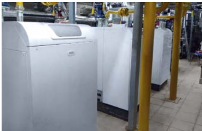
ЖК «Новое Лыткарино», г. Лыткарино Общая мощность котельной - 3,9 МВт
