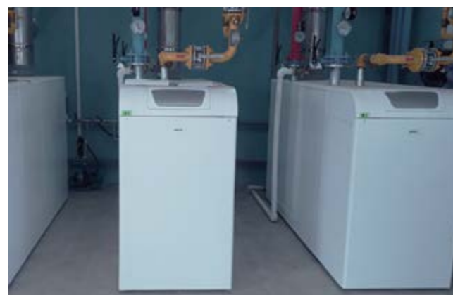
Жилой дом, г. Сочи Общая мощность котельной - 1,5 МВт
