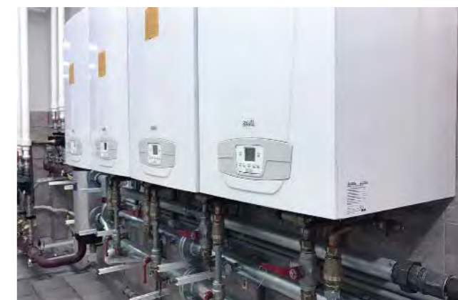
Общежитие, г. Усть-Луга Общая мощность котельной - 300 кВт
