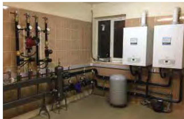
Автосервис, г. Москва Общая мощность котельной - 300 кВт
