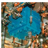
Подвешенный Компаблок в системе конденсации
