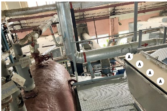
Фото 2. Фотография с места установки лучисто-конвективной панели в котельной (рабочая зона обслуживания у верхнего барабана котельного агрегата; вид Б: А — равномерно расположенные контрольные точки измерения скорости истечения воздуха из панели ПЛИ)
