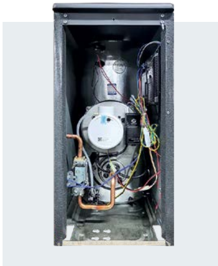
❖ Напольный газовый двухконтурный котёл TGB HiFin со снятой передней панелью
