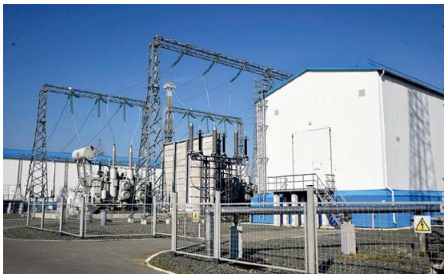
❖ Фото 2. Электрическая подстанция «Салехард» мощностью 250 (2×125) МВА
