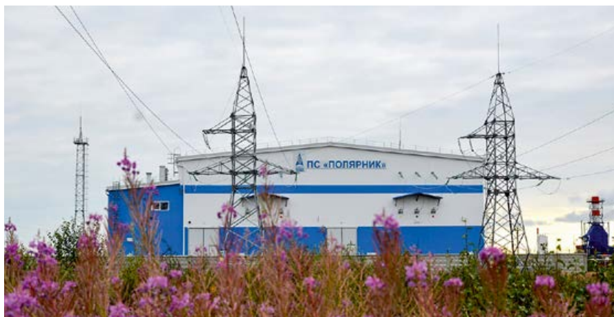
❖ Фото 1. Электрическая подстанция 110 кВ «Полярник» мощностью 80 (2×40) МВА
