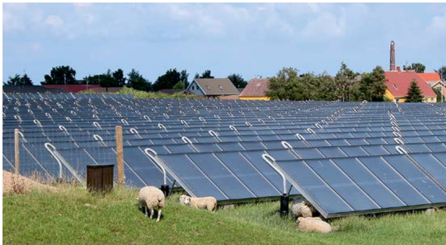
•• Фото 1. Система отопления на базе солнечных коллекторов в городе Марсталь (Дания)
