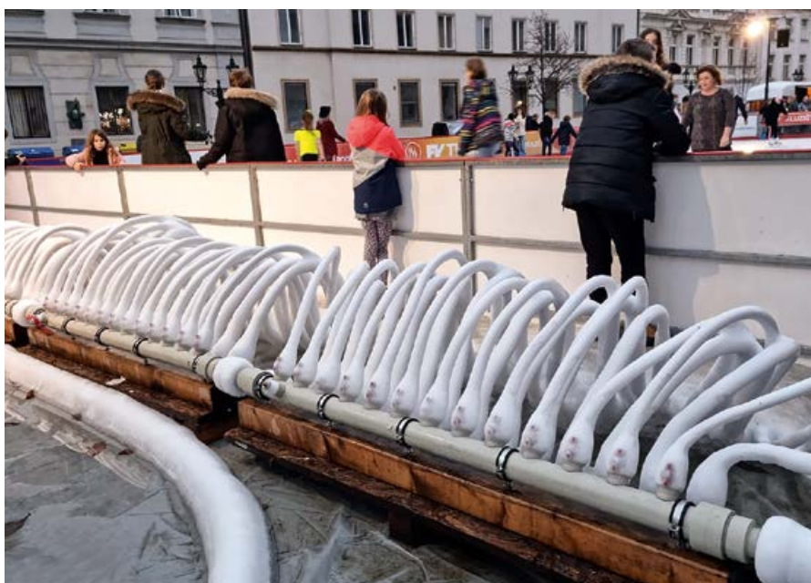
⚡ Полипропиленовый коллектор охлаждающего контура на катке в городе Праге, Чехия
