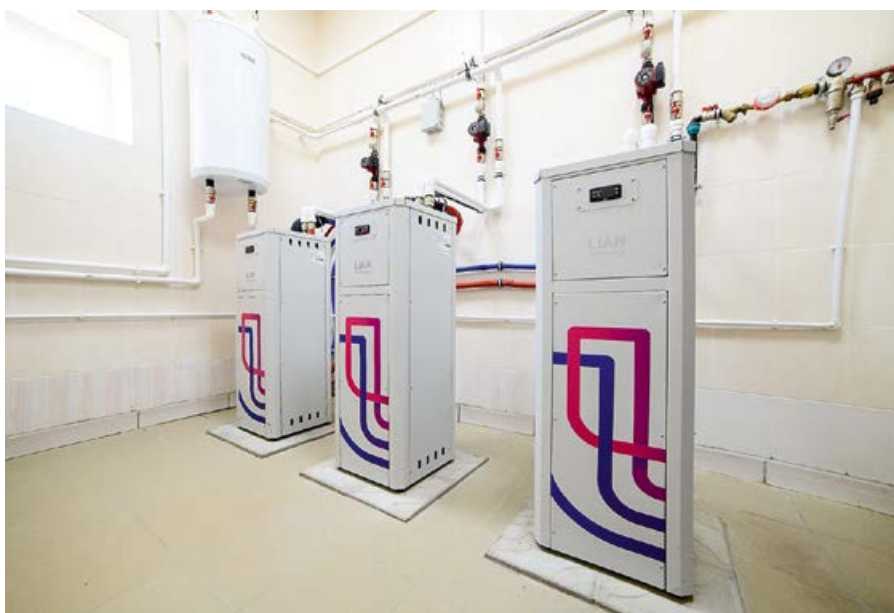
❖ Каскад инверторных тепловых насосов LIAN-HW 12.1 direct exchange , максимальной теплопроизводительностью 36 кВт, для энергоснабжения магазина в посёлке Сузун
