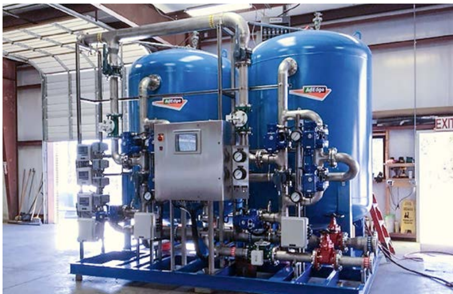
•• Установка AdEdge в городе Розуэлле, штат Джорджия (США), обеспечивает очистку сточных вод на уровне менее 0,3 мг/л по железу и менее 0,05 мг/л по марганцу
