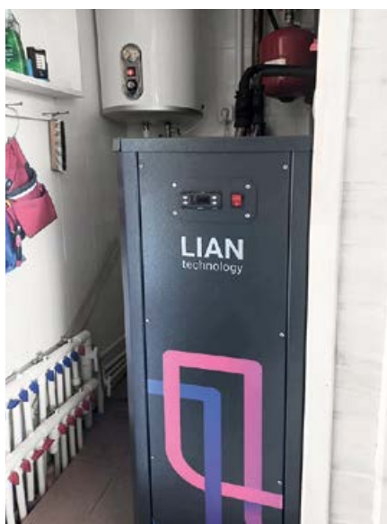
❖ Инверторный тепловой насос LIAN-HW 12.2 direct exchange в одноэтажном жилом доме
