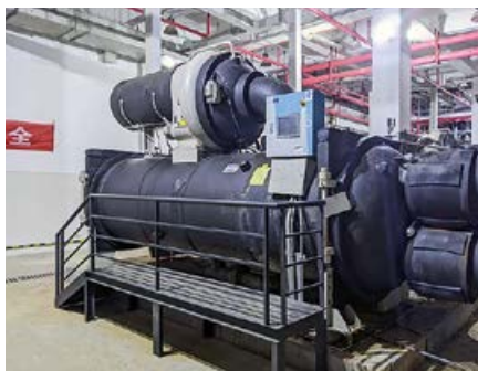
❖ Центробежный чиллер в аэропорту Янъяй
