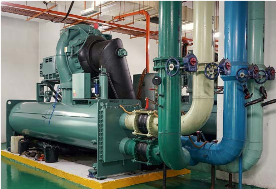
❖ Чиллерная установка (холодильная машина) с водяным охлаждением
