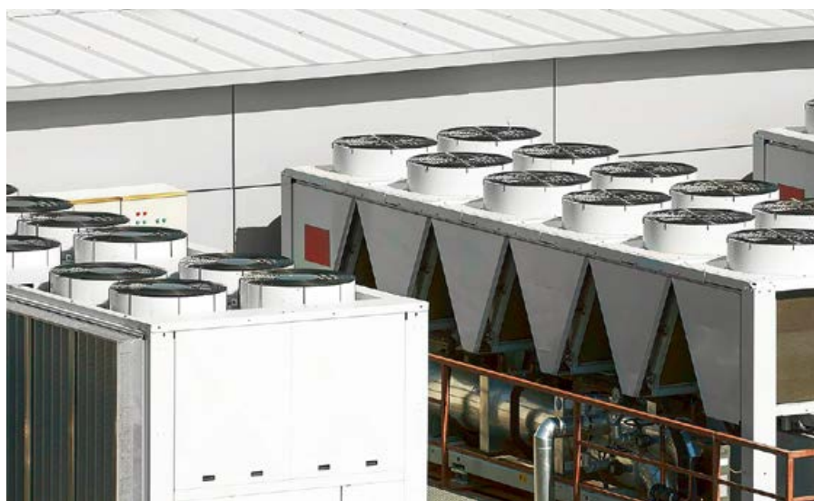
•• Чиллеры с конденсаторами воздушного охлаждения
