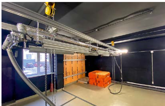
❖ Фото 1. Общий вид Лаборатории лучистого отопления ННГАСУ
