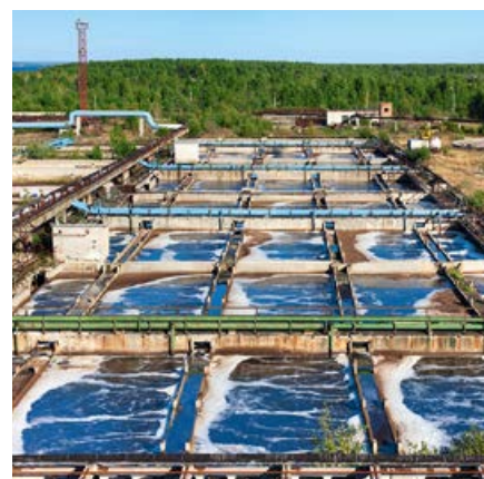
Стандартный каскад прудов биоочистки на канализационно-очистной станции
