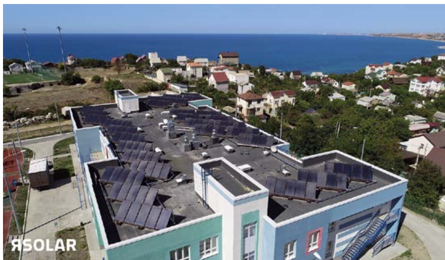
❖ Фото 2. Гелиоустановка с СК «Новый Полюс» в ГБДОУ №126 в городе Севастополе
