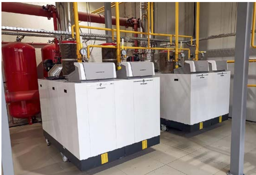
❖ Новые котлы De Dietrich C 640-1300 в помещении котельной
