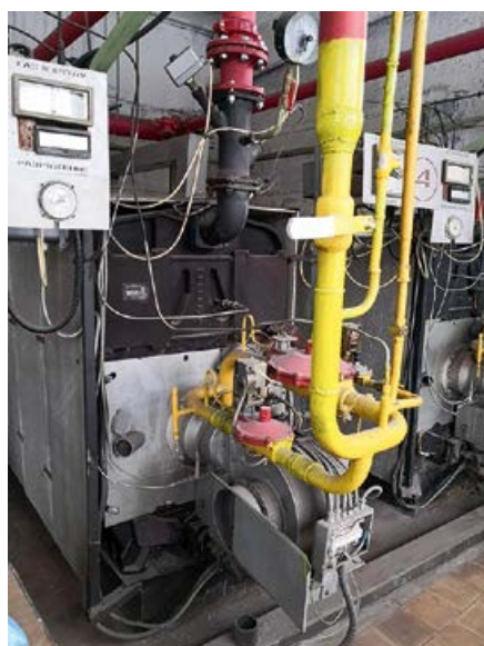
❖ Старый котёл в помещении котельной
