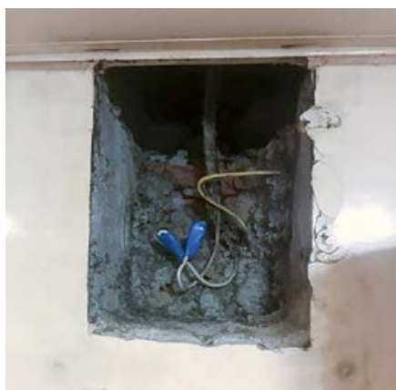
❖ Фото 3. Вентотверстие в ванной комнате жилой квартиры в Томске без вентилятора
