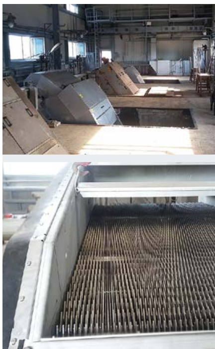
:: Фото 6. Ступенчатые решётки тонкой очистки на ОСК «Оренбург Водоканал»
