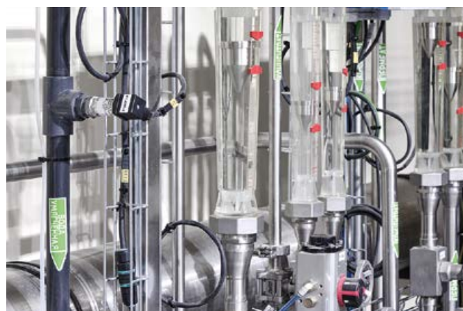
:: Ротаметры, установленные на подсистеме обратного осмоса
