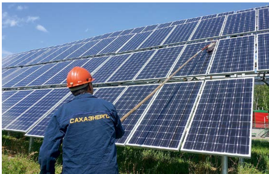
•• Солнечная электростанция (60 кВт) в селе Батамай (Кобяйский улус, Республика Якутия)
