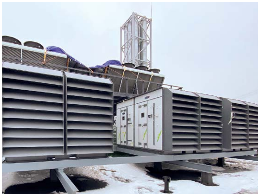
❖ Фото 1. Оборудование «ВЕЗА» на крыше дата-центра крупной российской компании
