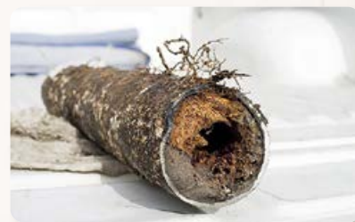
❖ Фото 5. Коррозия в железной трубе
