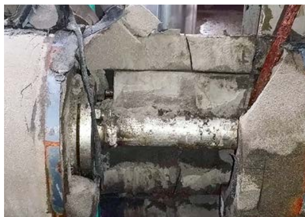
❖ Фото 3. Фрагменты трёхслойного теплоизоляционного покрытия. Видно увлажнение внутренних слоёв и сечения конструкции
